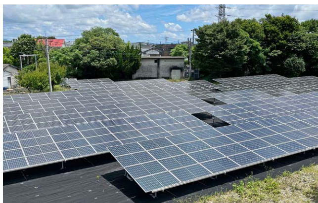
八代工場敷地内に設置した太陽光発電設備
